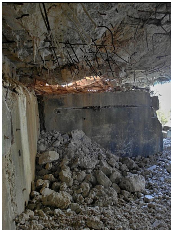
▲ [5024235] Blick vom Bereitschaftsraum in die rechte Gasschleuse. (Bild: © WWMP 21.06.15)
