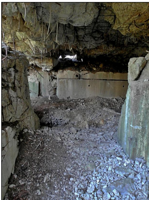
▲ [5024234] Blick von der rechten Gasschleuse in den Bereitschaftsraum. (Bild: © WWMP 21.06.15)
